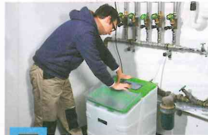
44 Enthärtungsanlage Dem Kalk an den Kragen
