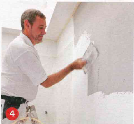
4 Beginnen Sie mit dem Auftragen des Putzes oben an der Wand. Ziehen Sie mit flacher Kelle zunächst eine 2-3 mm dicke Lehmschicht auf.
