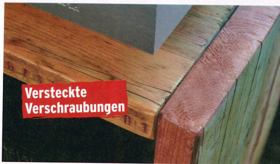
Nicht zu sehen: Die Verschraubung ist weder von oben noch von vorn zu erkennen
